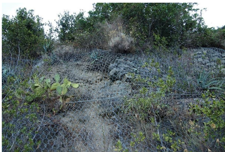
Figura 3.5: Esempio di crolli in corrispondenza del sistema di rafforzamento corticale realizzato lungo la falesia sovrastante il sentiero nel settore B, non contrastati a causa dall'inadeguata armatura (barre di ancoraggi/funi di rinforzo) del sistema in opera.
