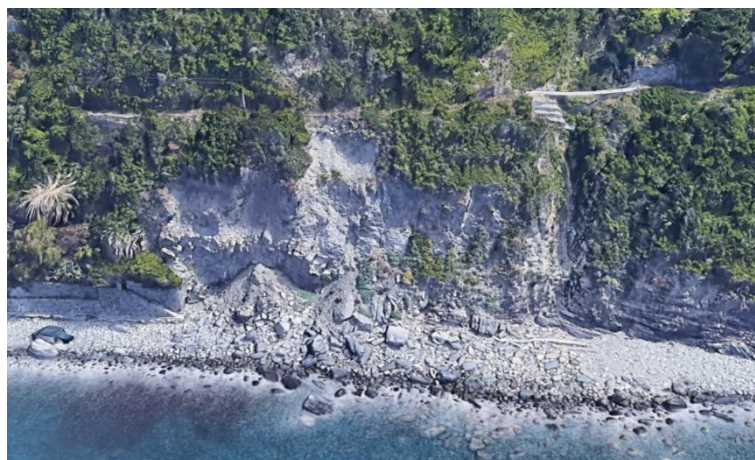
Figura 4.1: Esempio di rischio per la stabilità della sede pedonale associato a dissesti originati a valle della stessa – Settore D – fenomeno franoso in regressione dal piede del versante alla sede pedonale
