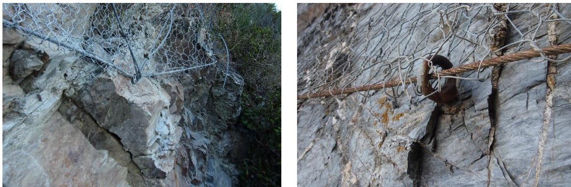
Figura 3.6: Reti di placcaggio nei settori A e B: morsettature carenti, ancoraggi inadeguati, inadeguata protezione contro la corrosione della componentistica.
